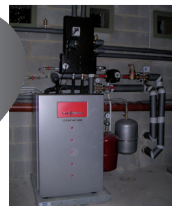
Pompe à chaleur géothermique
