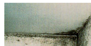
Moisissures causées par un pont thermique
