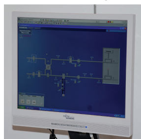
Poste de gestion des systèmes de ventilation mécanique d'un immeuble de logement
