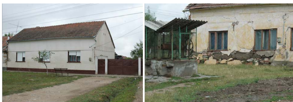
Façade de la maison du maire de Maureni présentant les caractéristiques dites classiques de la maison souabe (05/06), détail d'une façade lézardée et des murs qui s'effritent (05/06).
