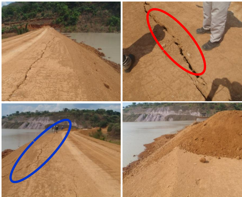
Figure I-8: Effondrement de la grande digue de Kakanda
