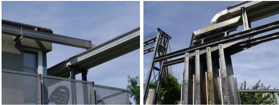
Figure 117 – Dispositifs de collecte intermédiaire entre les différents chéneaux. Ceux-ci s'assemblent de manière démonstrative de leur fonction sans souci d'intégration à l'ensemble construit.
