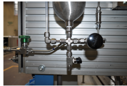
Figure C.28: Purge système d'évaporation.
