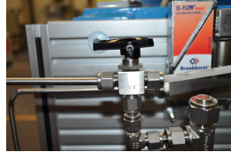
Figure C.18: Position vanne vide réservoir.
