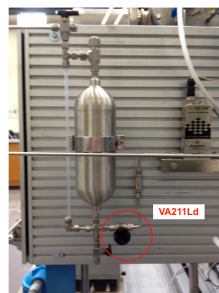
Figure C.16: Vanne sortie réservoir.
