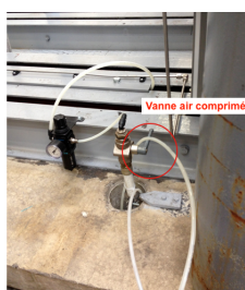
Figure C.14: Vanne d'arrivée d'air comprimé.
