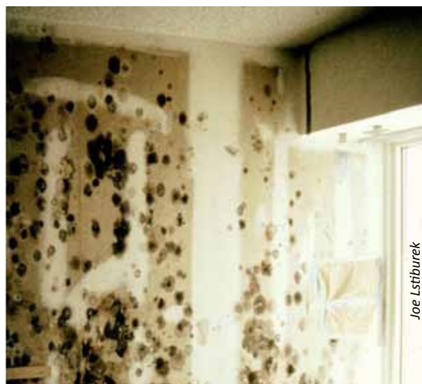
Exemple de moisissures dues à la condensation.
