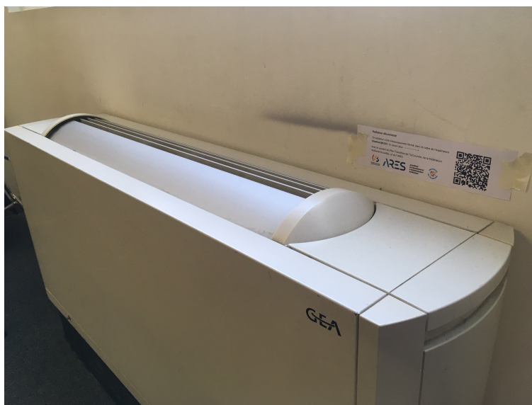
Figure 2 Exemple de ventilo-convecteur isolé en phase ZONAGE (ici dans le couloir du 4e étage)
