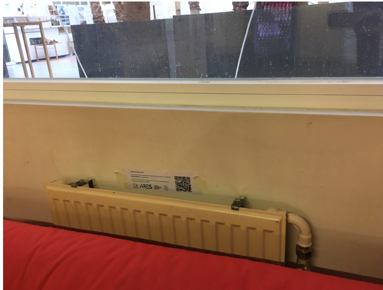
Figure 1 Exemple de radiateur isolé en phase ZONAGE (ici dans le sas d'entrée de la cafétéria)
