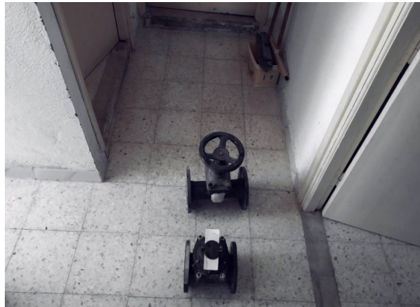
Figure 25 : Vanne à opercule et compteur d'eau confisqués par un GDA d'un périmètre modernisé de la Manouba
