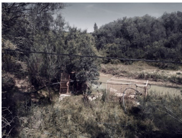
Figure 12 : Pompage « illicite » électrifié situé au niveau de l'oued Medjerda
