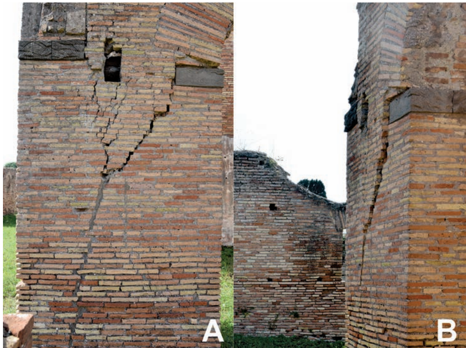
Fig. 28 – Caseggiato dell'Ercole (IV, II, 2-3), fissuration sur le mur sud du couloir 20 ; A : vue de face, B : vue latérale avec torsion du mur (photographie de l'auteur).
