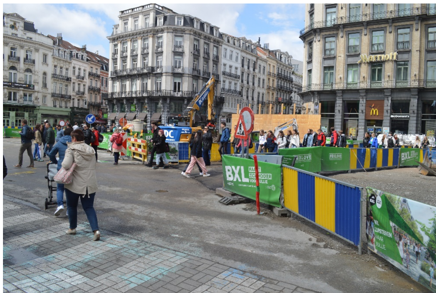
Fig.12 : Situation d'engorgement typique du piétonnier.
