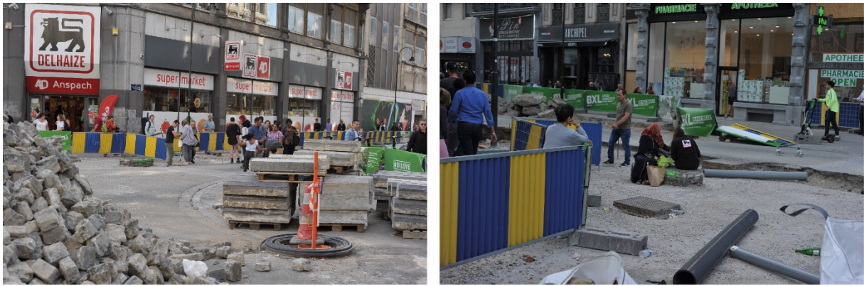
Fig.25 : Ouverture illicite des périmètres des travaux.
