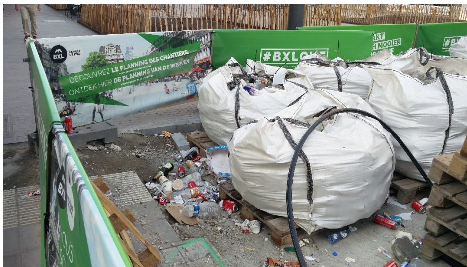
Fig.23 : Travaux utilisés comme benne à ordures.
