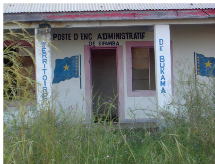
Photo 1 - Poste d'encadrement administratif de Kinkondja sans portes ni fenêtres.
