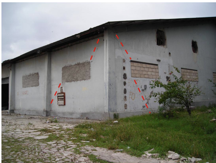
FIGURE 4.17 – Fissures de gonflement sur le bâtiment 6 de la SONAPI
