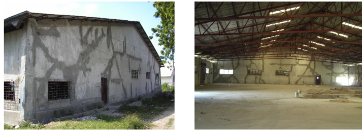
FIGURE 1.6 – Dégradations observées sur un bâtiment industriel à la SONAPI (photo prise par Kelly Guerrier avant le séisme du 12 janvier 2010)
