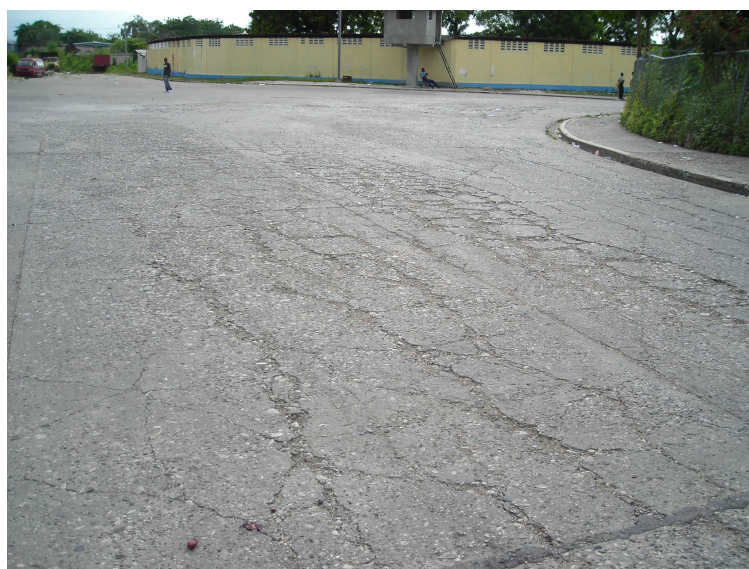
FIGURE 3.2 – Réseau de fissures sur les voies de circulation de la SONAPI
