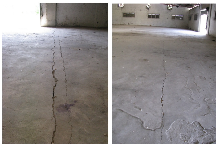
FIGURE 3.4 – Fissures sur le parquet du hangar 6 de la SONAPI
