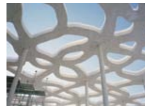
Montricher - Suisse (Maison de l'écriture, Muttoni et Fernandez (ing.), Mangeat et Wahlen (arch.))
