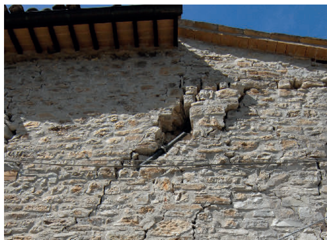
Bild 7. Durchstanzversagen eines Fassadenankers in Castelsantangelo sul Nera beim Erdbeben von Amatrice in Italien 2016 Abb.: T. Wenk
